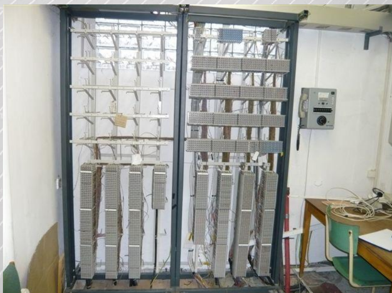
Hlavní rozvod telefonní ústředny.
